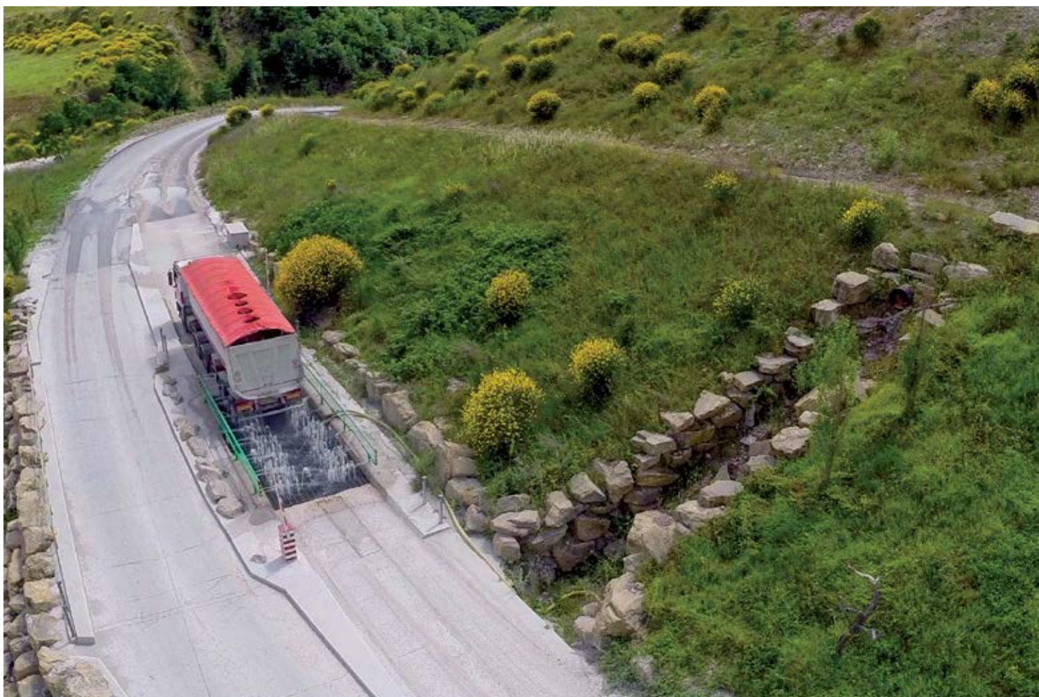
Sistema automatico di lavaggio degli pneumatici dei mezzi pesanti in uscita dall'area di cantiere
